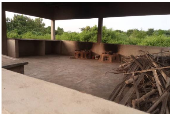
Photo 3 : Cuisine construite par le projet CHOITHRAMS pour soulager les peines des cuisinières (EPP Sazuékpa)
